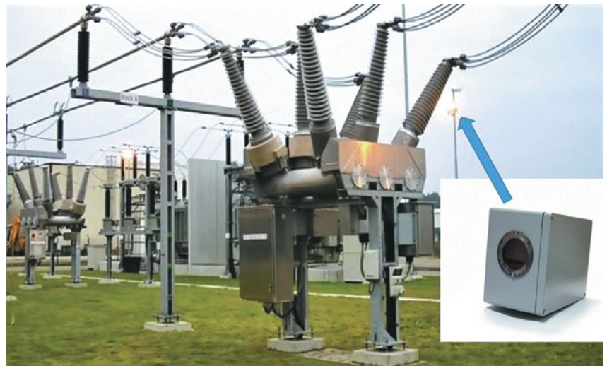
Рисунок 4. Пример расположения тепловизионных модулей АСТРОН-ТА в автоматизированной системе круглосуточной тепловизионной диагностики
